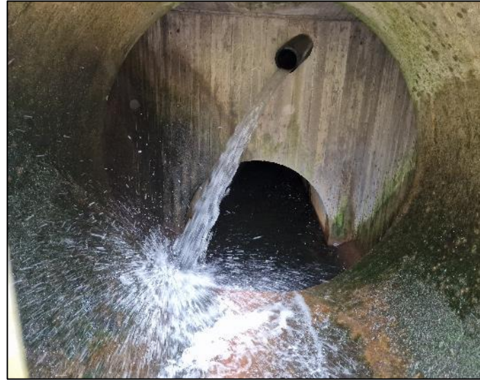
Figur 4.26 Bräddinlopp till Moralundstunneln vid Rosersbergsbäcken. Rosersbergsbäckens vatten bräddade inte in i tunnelns vid fältbesöket. Vattenflödet som syns på bilden är kondensvatten från Bristaverket.
